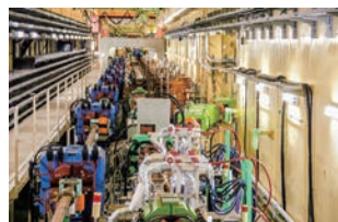
SuperKEKB 加速器のトンネル内直線部の様子 (p.10 図2参照)。
