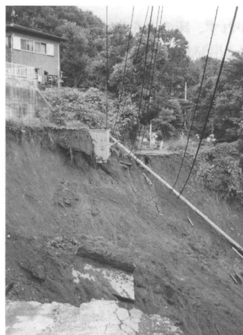
図12 八王子市横山町の崖崩れ現場 (山本氏提供)
